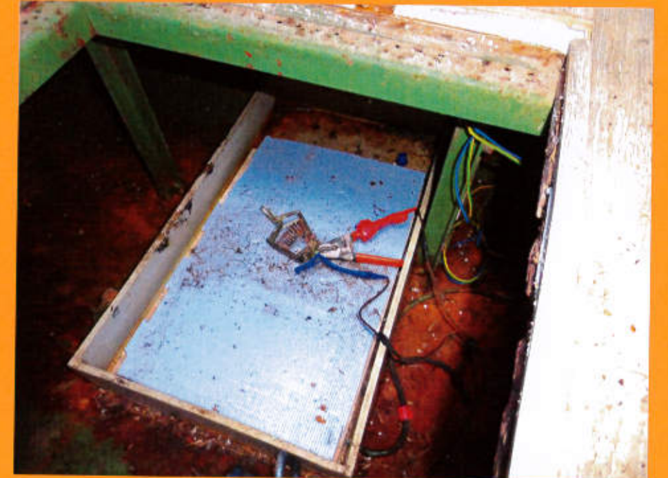
LOGEMENT DE BATTERIE
